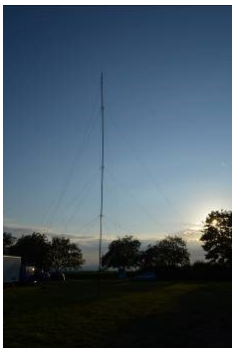
Einer der Antennenmasten im malerischen Sonnenuntergang beim „Atillafelsen“.
